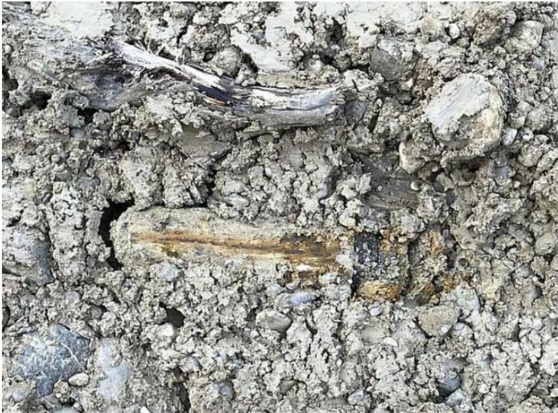
Bei Baggararbeiten in Icking gefunden: Ein Artilleriegeschoss aus dem Zweiten Weltkrieg. © Polizei
